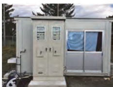
現場実験室および制御盤
